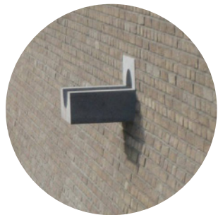
Hemelwater via een spuwer het Damsterdiep in laten lopen
